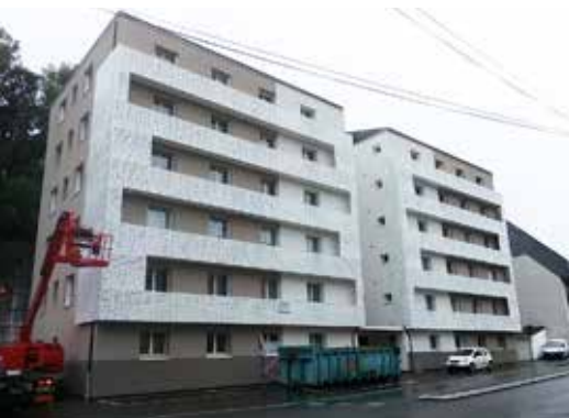
Une copropriété en cours de rénovation, rue de Callac à Morlaix, ayant bénéficié des aides de l'OPAH Copropriétés
