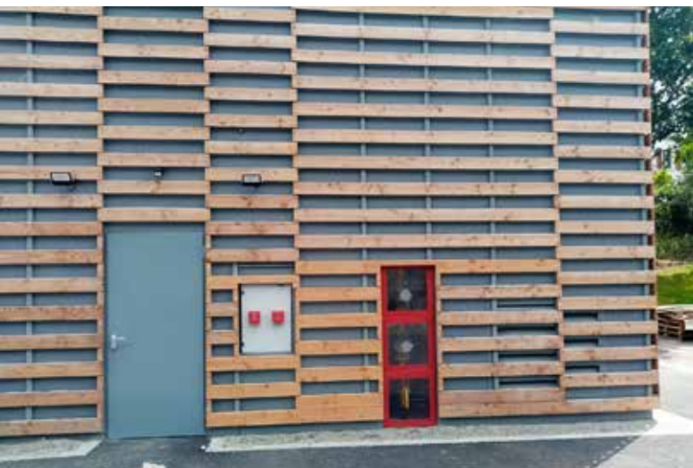
Chaufferie bois - Morlaix
